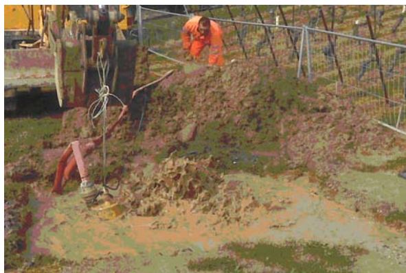
Figure 19 : Fuite d'air comprimé par un trou de sondage
