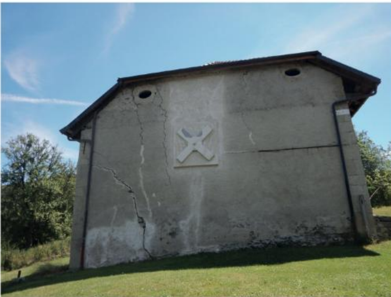
Image 6. Désordres à l'extérieur des bâtiments
