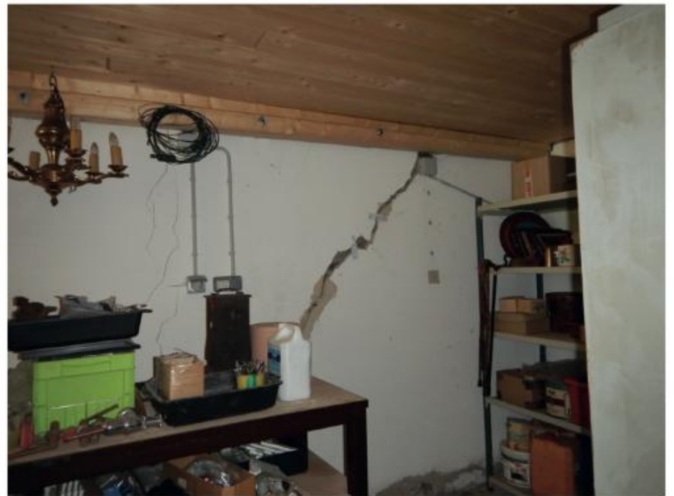
Image 7. Désordres à l'intérieur des bâtiments
