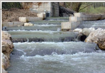
Passé à poissons sur l'Allondon (GE) Maîtrise d'œuvre
