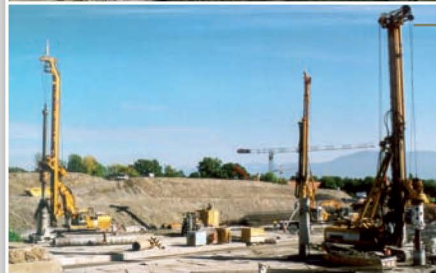
■ Station de traitement d'eau des Tuileries (GE) Études géotechniques et maîtrise d'œuvre
