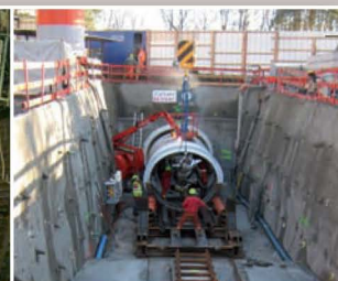
■ Galerie d'évacuation d'eaux usées de Chouilly, St Genis-Pouilly (01) Maîtrise d'œuvre
