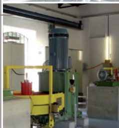
Groupe turbo-alternateur de l'usine hydro-électrique de Vessy (GE) Maîtrise d'œuvre
