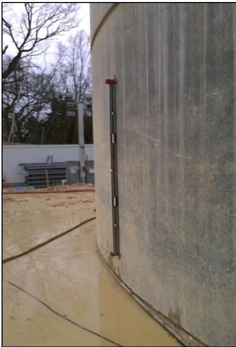
Figure 8a. Instrumentation de suivi de verticalité de la pile P1
